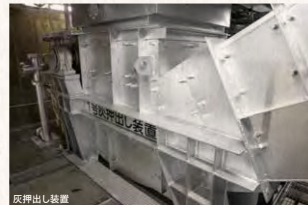
灰押し出し装置
