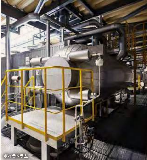
ボイラドラム
