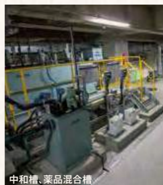
中和槽、薬品混合槽
