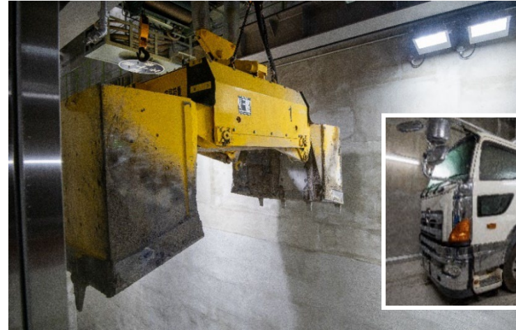
灰クレーンは灰をつかみやすい形状をしています。灰クレーンで灰をつかみ、トラックに積み込みます。
